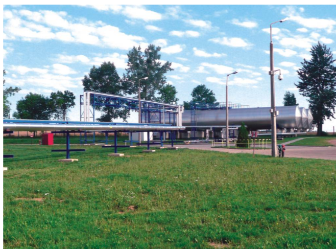
Zbiorniki Magazynowe Estrów
